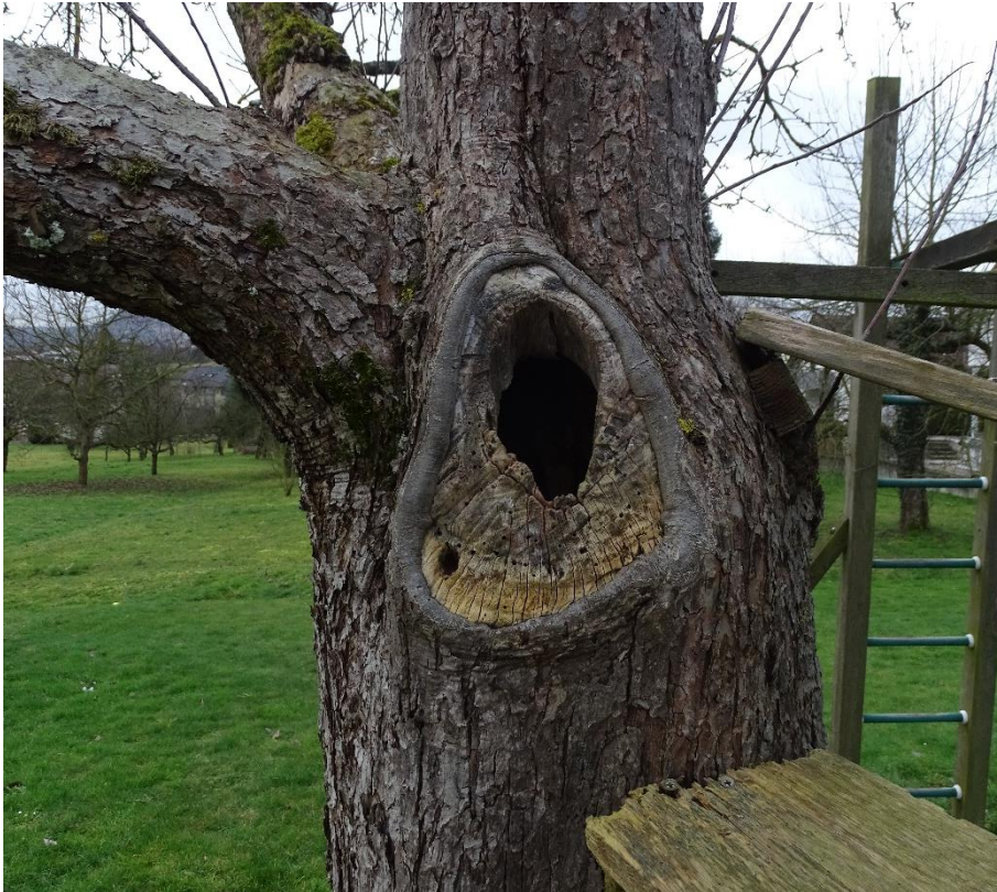
Abb. 3: Tiefe Stammhöhlen in alten Obstbäumen können von streng geschützten Totholzkäfern besiedelt werden.
