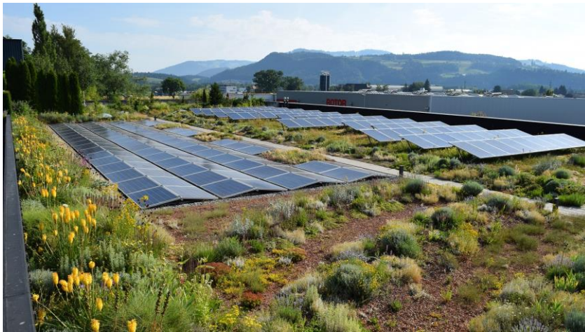
Extensives Gründach mit PV (BGG – Bundesverband für Gebäudegrün)
